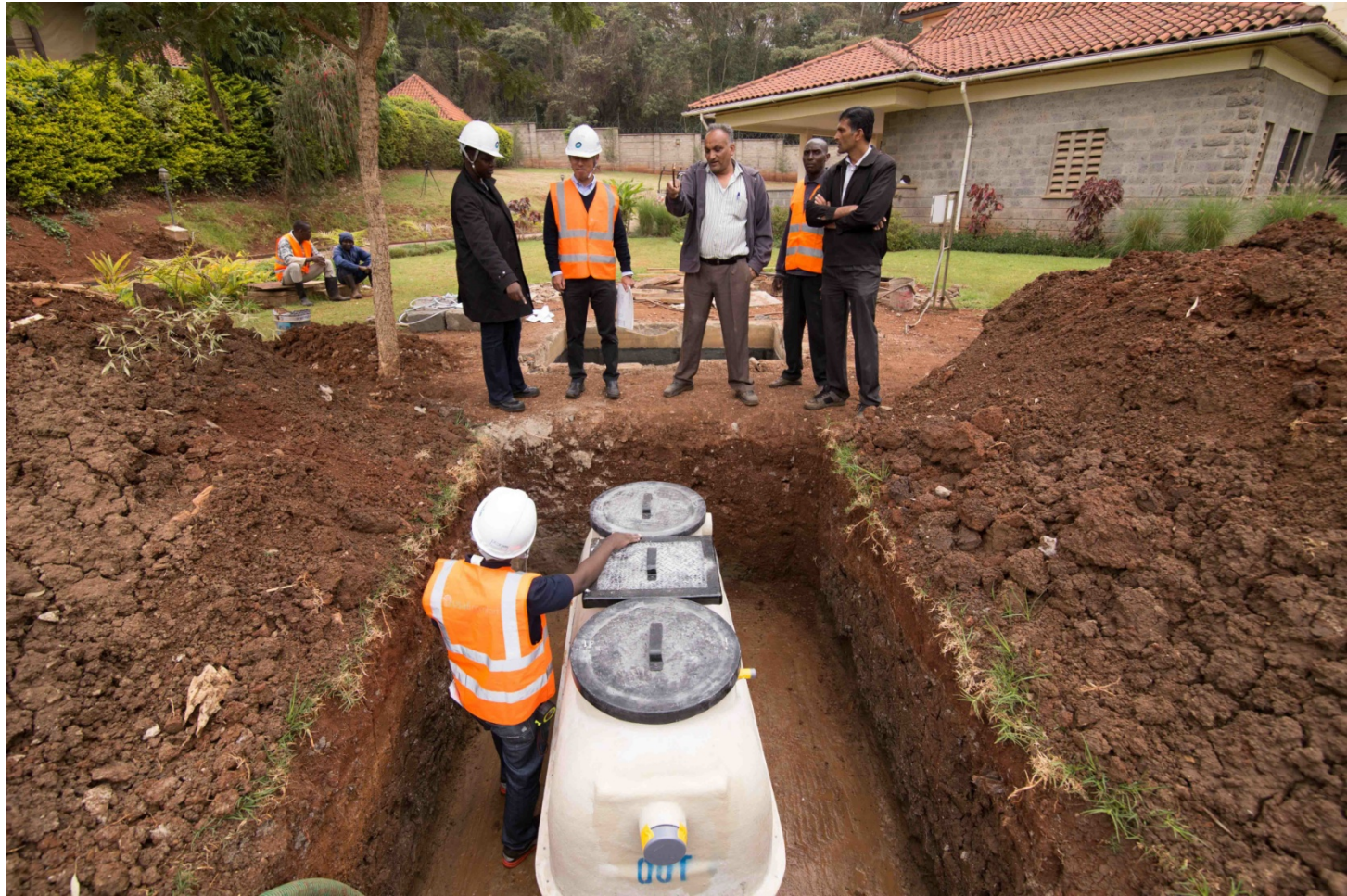
Installation Johkasou à Petite échelle_1m3 / jour
