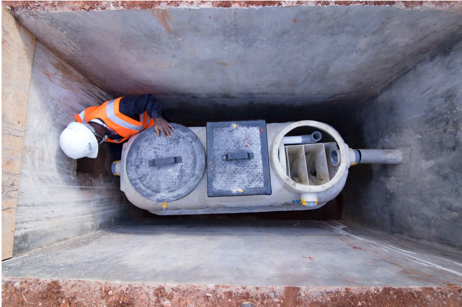
Installation Johkasou à Petite échelle_1m3 / jour
